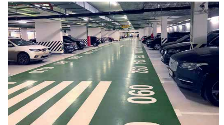
БЦ «Эрмитаж Плаза» – «Вымпелком», Москва, Sikafloor®-1324 (MasterTop 1324)
